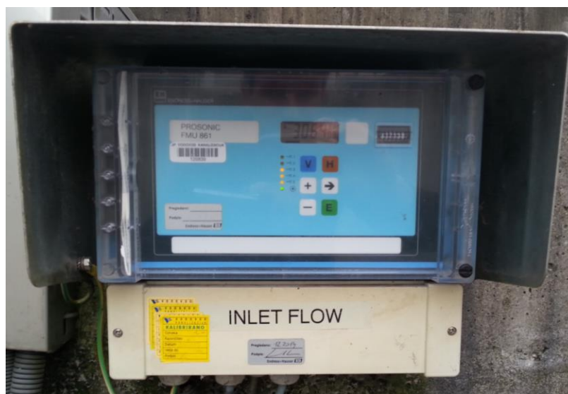
Slika 58: Zaslon merilnika pretoka (venturimeter) Vir: Lasten
